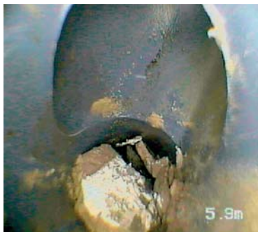
Ablagerungen im Kanalrohr
