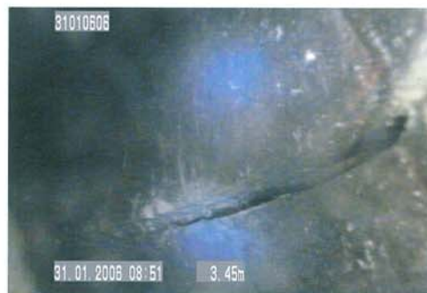
Bruch des Kanalrohres
