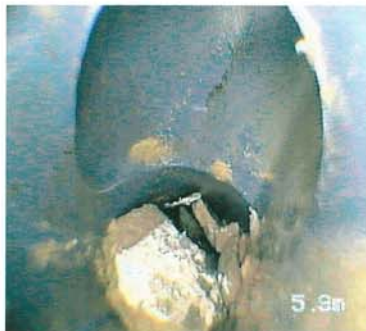
Ablagerungen im Kanalrohr
