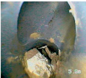
Ablagerungen im Kanalrohr
