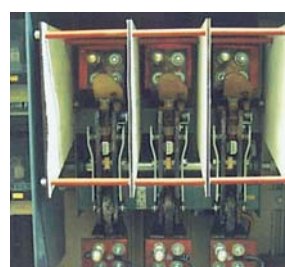
Eine überhitzte Verbindung
